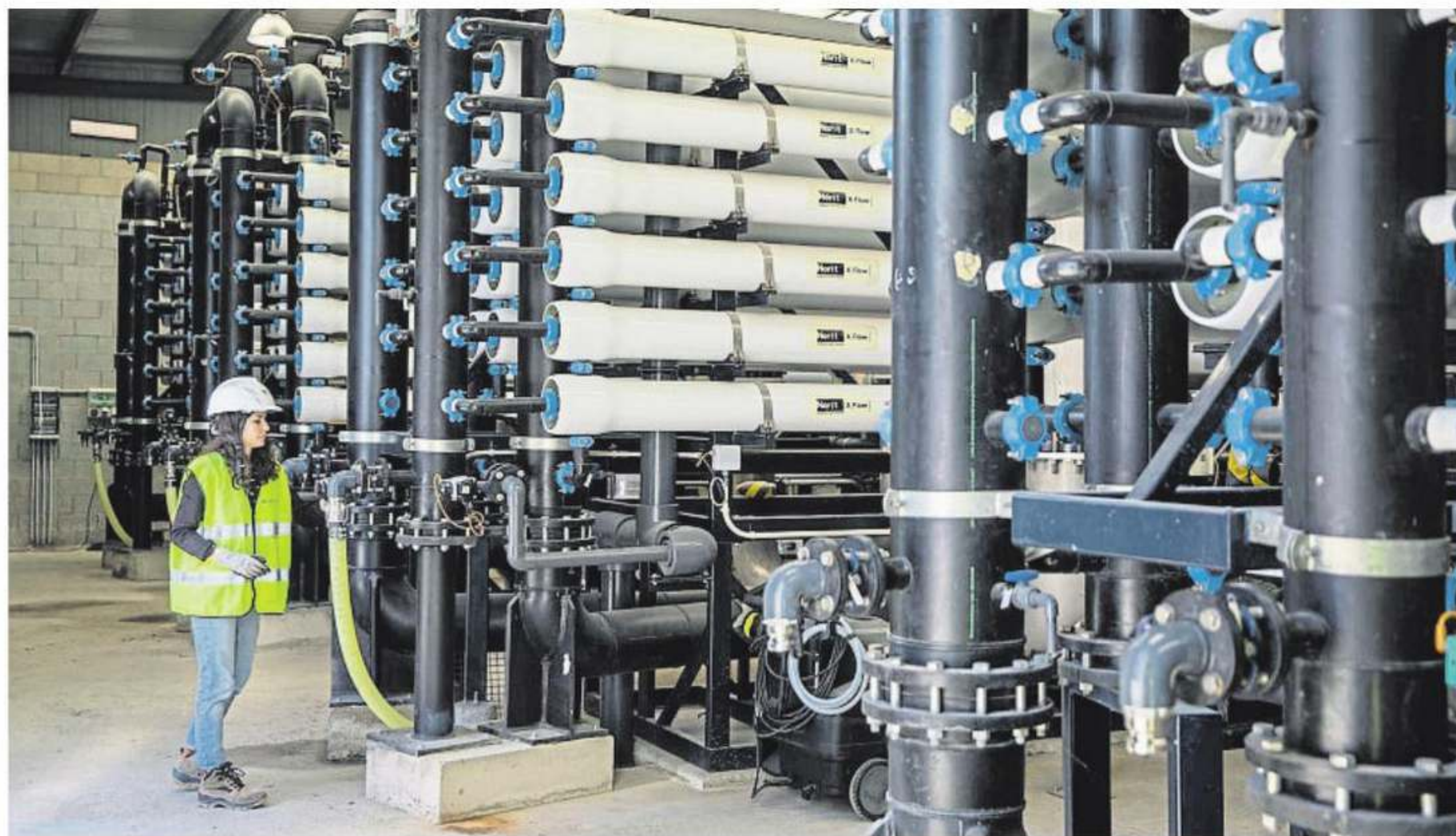
Instalaciones de la ampliación de la estación potabilizadora de Aigües de Barcelona de Trinitat
